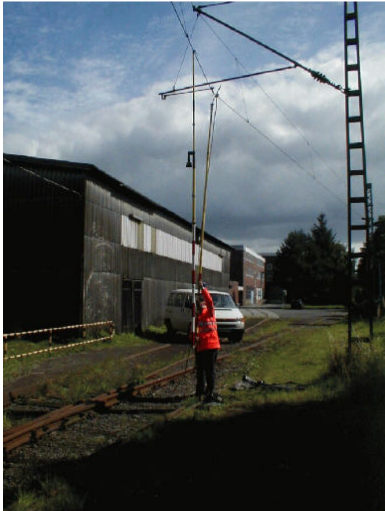
Abbildung 10: Bahnerdung durch Notfallmanager
